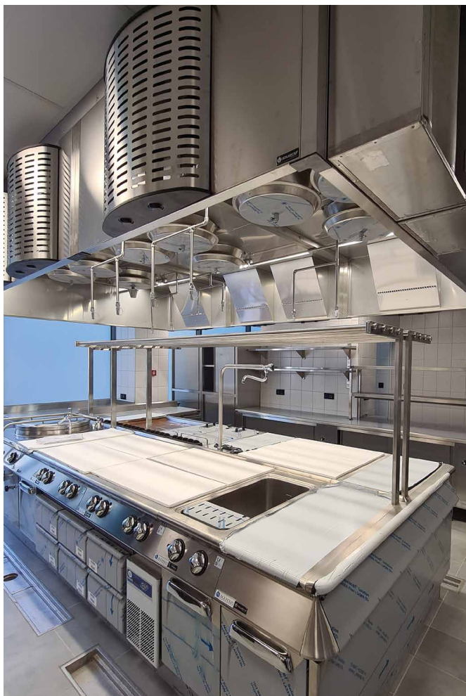
Okap kuchenny z filtrami TurboSwing wyposażony w system przeciwpożarowy ANSUL
