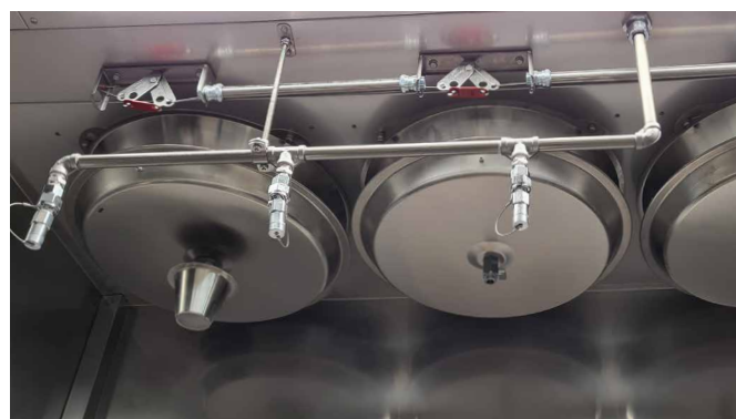
Elementy systemu przeciwpożarowego ANSUL
