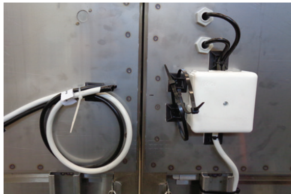
Przygotowane podłączenie elektryczne przy dwóch modułach. Puszka podłączeniowa bez oznaczenia, zdjęcie B.
