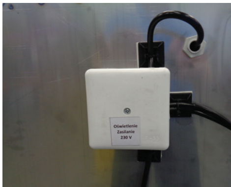
Puszka podłączeniowa z oznaczeniem "Oświetlenie - Zasilanie" 230V, zdjęcie A.
