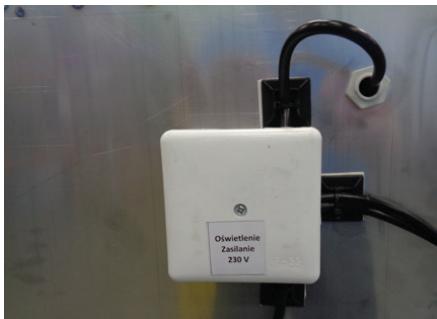
Puszka podłączeniowa z oznaczeniem "Oświetlenie - Zasilanie" 230V, zdjęcie A.
